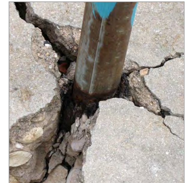
14. קורוזיה של חלקי הפלדה בתוך יציקות הבטון גורמת לסדיקה חמורה, לחדירת מים לתוך הבטון מחמירה את תהליך ההרס בבוסתן
