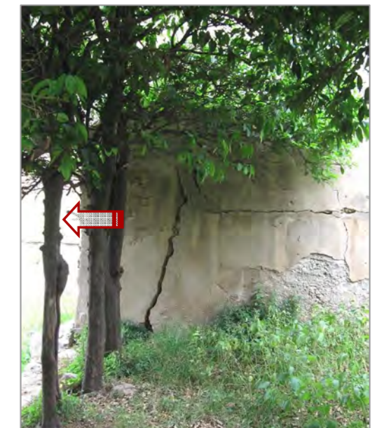
16ב. מבט מדרום: נטיית קיר התמך המערבי. יש צורך בהחדרת העוגנים ובגראוטינג.
