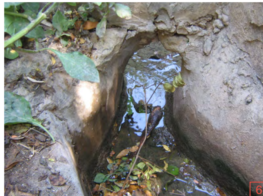
מבט לעבר הפתח שבדופן האגן הריבועי התחתון שמזרים מים מהאגן לתעלה האלכסונית, בליטות הבטון שגורמות להגברת לחץ המים.
