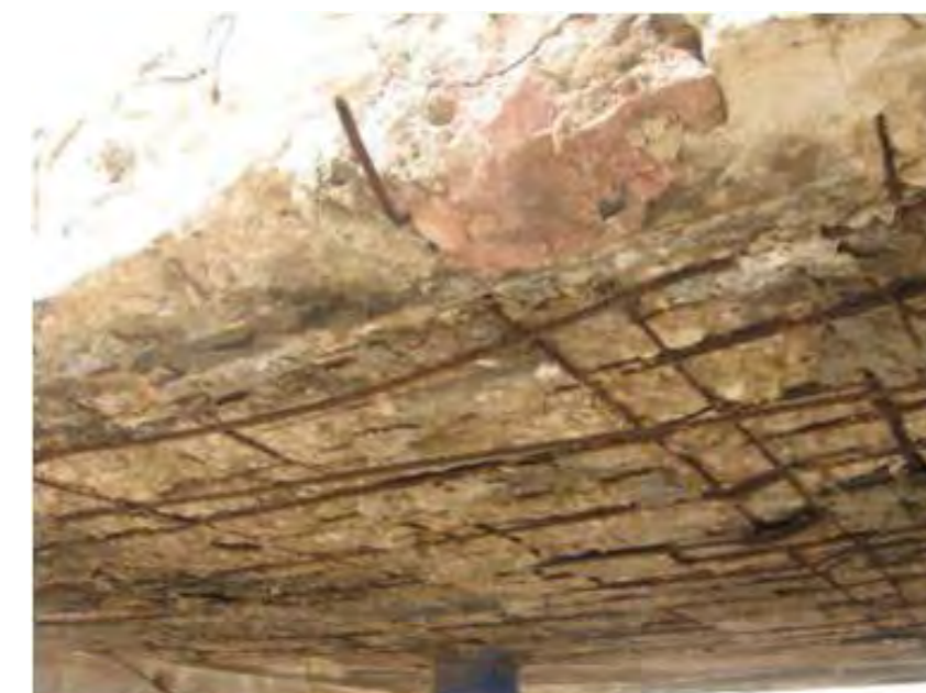
ברזלי זיון חשופים וחלודים בתקרת הבטון המחברת בין החדר הבנוי לבין הטרסה שמאחוריו
